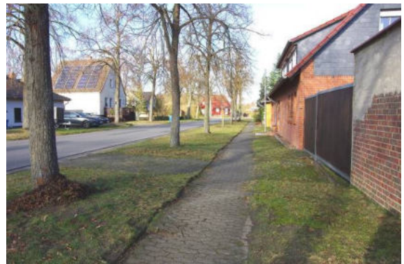
Der Gehweg im südlichen Verlauf des Drömlingsweges K 85 ist abgängig.
