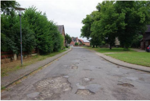
Die Straße Im Dorfe in Altendorf weist erhebliche Schäden auf; zudem fehlt ein gestalterischer Bezug zur Dorfmitte.
