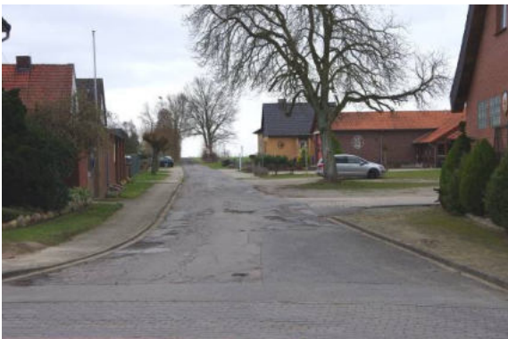
Der Tülauer Weg weist einen erheblichen Erneuerungsbedarf auf.
