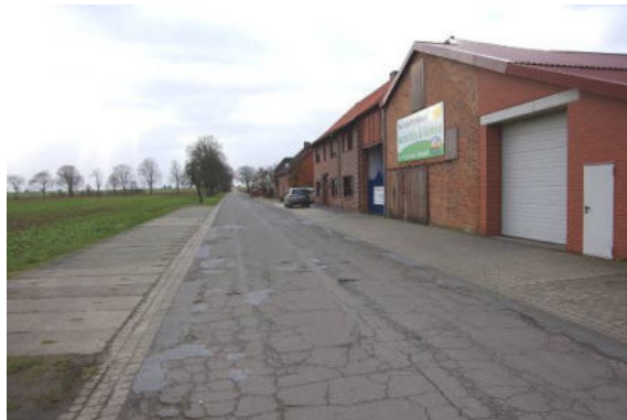
Seit vielen Jahren bedarf die Dörrheidenstraße einer grundhaften Erneuerung.
