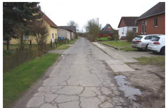
Auch der Straßenraum An der Dränke ist durch bauliche Schäden gekennzeichnet.
